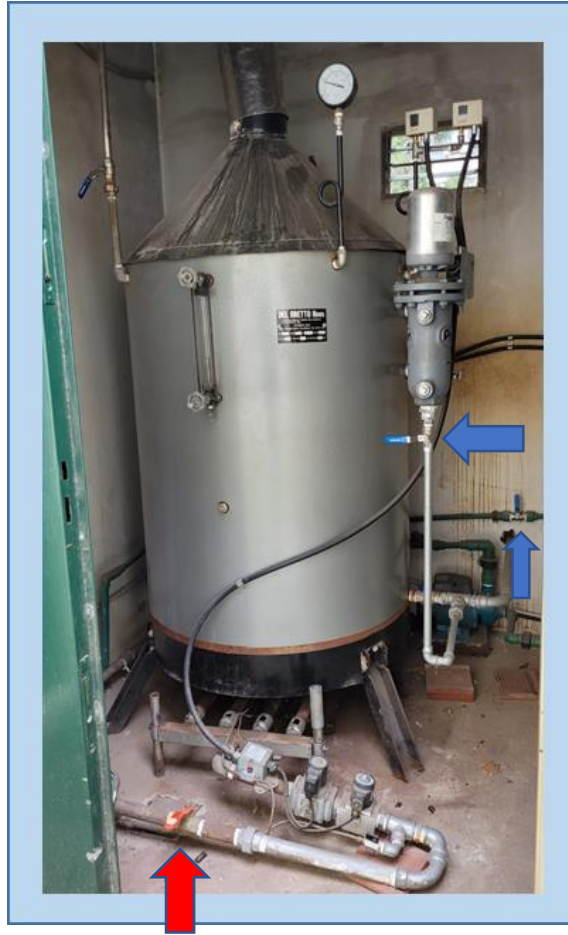
Figura 3: Caldera a vapor de 700 L.
